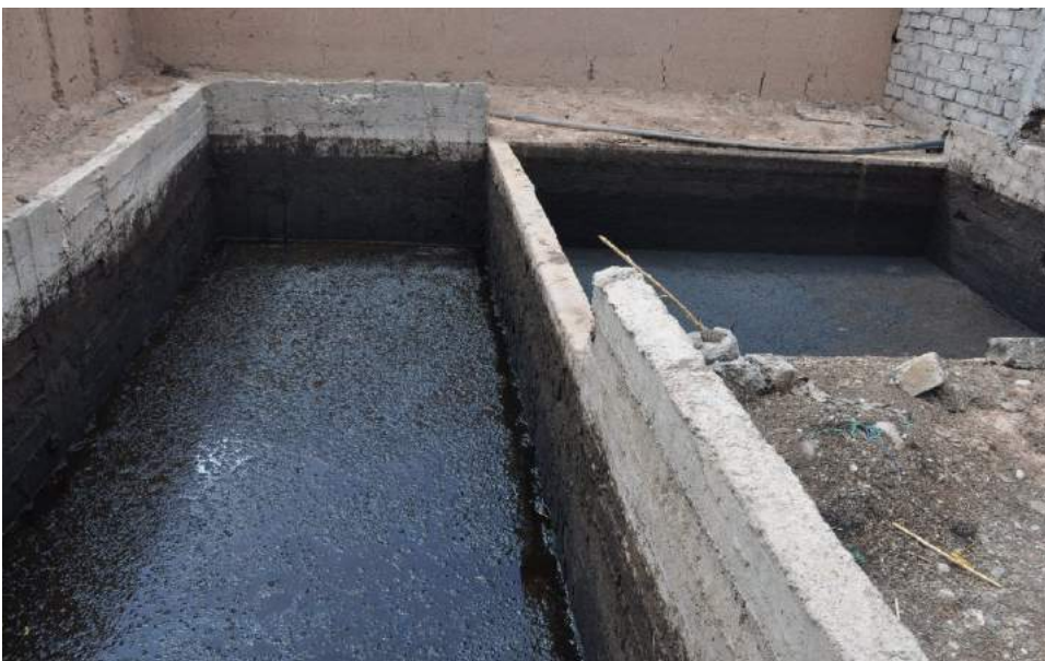
Bassin de récupération des grignons
