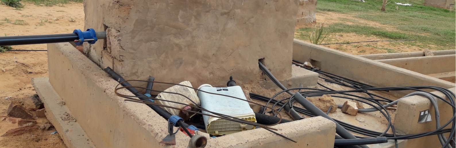
Bassin d'alimentation en eau du système d'irrigation au goutte à goutte
