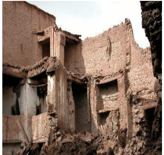
Photo13: Maison en ruines
