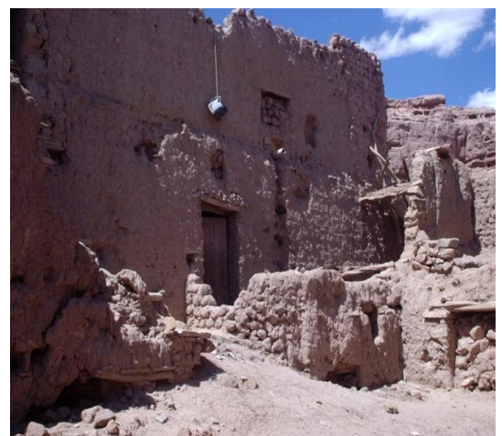
Photo14 : Maison en dégradation
